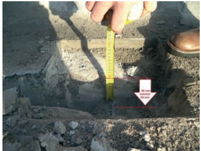
Fot. 5. Przykład niewłaściwej lokalizacji i ilości prętów zbrojenia stropu monolitycznego ujawnionej podczas ekspertyzy
