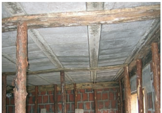
Fot. 2. Przykład nienormowego ugięcia stropu spowodowanego niewłaściwym podparciem
