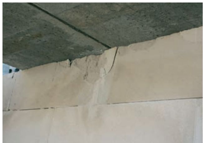
Fot. 6. Przykład uszkodzeń ściany z bloczków betonu komórkowego pod wpływem bezpośredniego oparcia stropu
