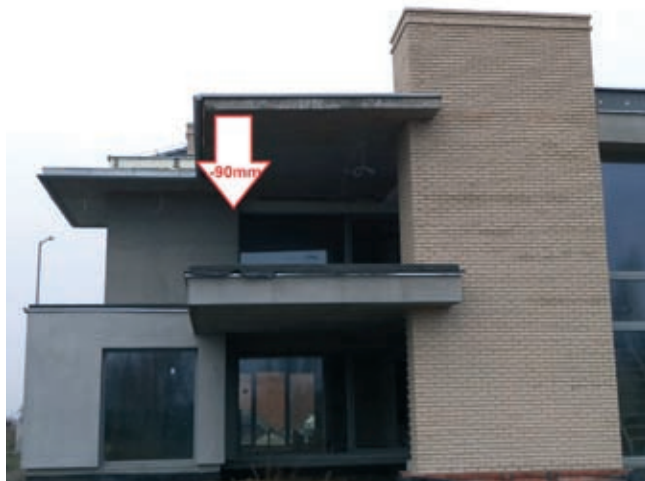
Fot. 7. Przykład nienormowego ugięcia stropu – balkonu. Zjawisko spowodowane niewłaściwym wykonaniem zbrojenia, użyciem betonu o zaniżonej klasie wytrzymałości, brakiem odpowiedniej pielęgnacji świeżego betonu w warunkach zimowych
