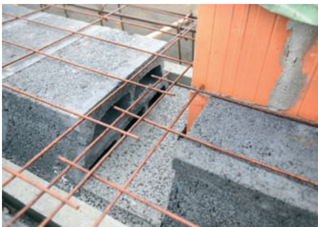
Fot. 4. Przykład za małego zakładu prętów na połączeniu siatek zgrzewanych w nadbetonie stropu gęstożebrowego
